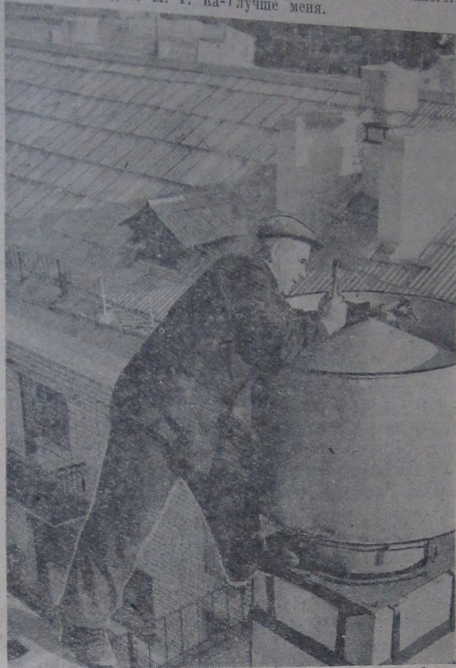
На снимке: кровельщик строительного управления левобережья Михаил Катерин устанавливает диффлектор на новом доме. Фото и текст Ю. ТУМАНОВА.
