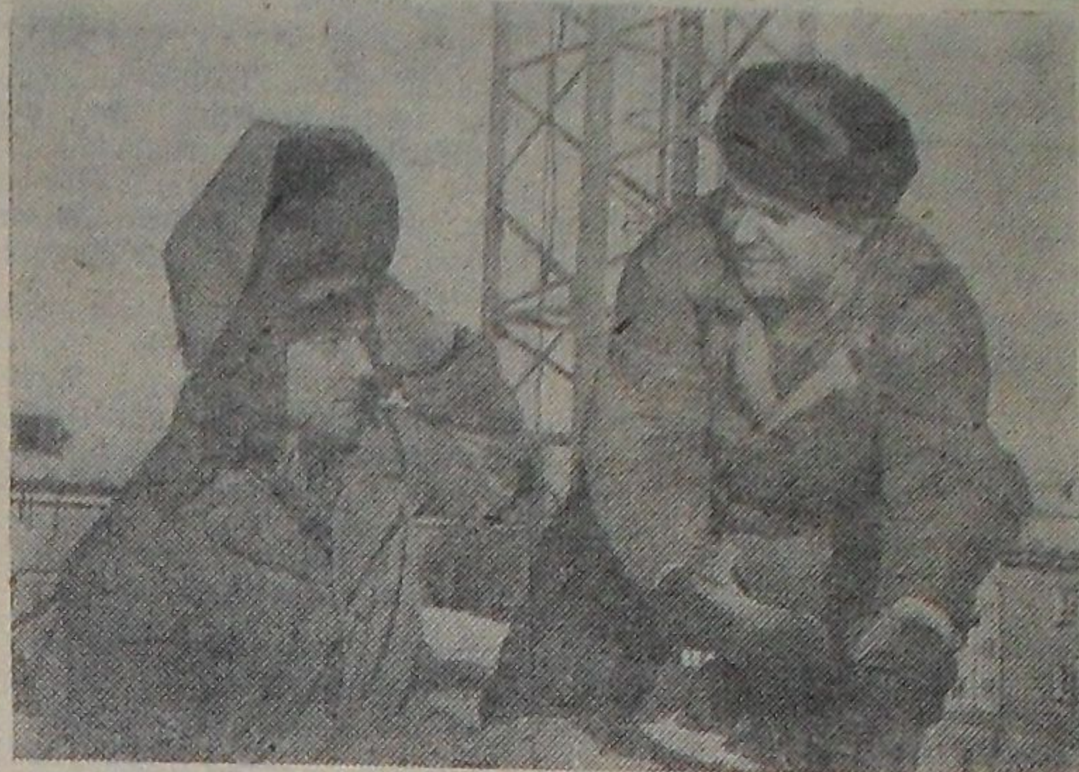
«На объекте ведет монтаж бригада коммунистического труда строительного управления «Монтажжилстрой», воз- главляемая А. Кремелем». Такой плакат висит на одном из строющихся зданий в Усть-Каменогорске. На монтажной площадке нет склада готовых панелей. Детали доставляются сюда с домостроительного комбината и прямо с машины ус- танавливаются на место. Прогрессивный метод монтажа «с колес» бригада переняла у ленинградских строителей.
