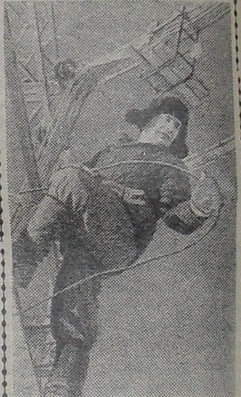
На строительстве белорусской атомной электростанции имени И. В. Курчатова в Свердловской области электромонтажники ведут работы у главного ввода, прокладывают высоковольтные линии электропередачи. На снимке: Герой Социалистического Труда А. С. ЛЕБЕДЕВ в момент монтажа главного ввода. Фотохроника ТАСС
