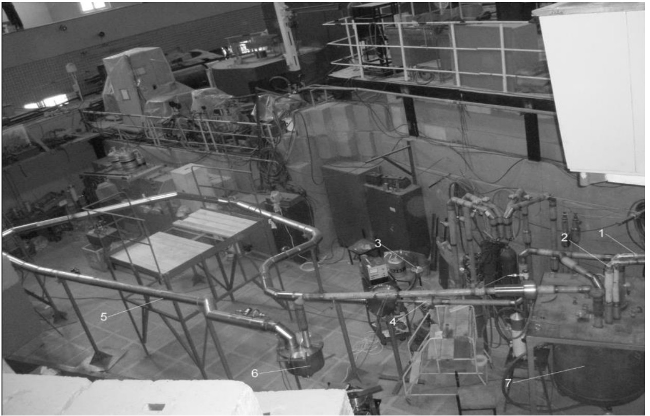
Рис. 35. Испытательный стенд в экспериментальном зале ИБР – 2: 1) трубопровод отвода гелия от КГУ к криостату, 2) трубопровод подвода гелия к КГУ от криостата, 3) место расположения дозатора, 4) трубка Пито, 5) пневмотранспортный трубопровод, 6) камера-имитатор, 7) криостат с теплообменником, криогенным гелиевым насосом (газодувка) и криогенными вентилями
