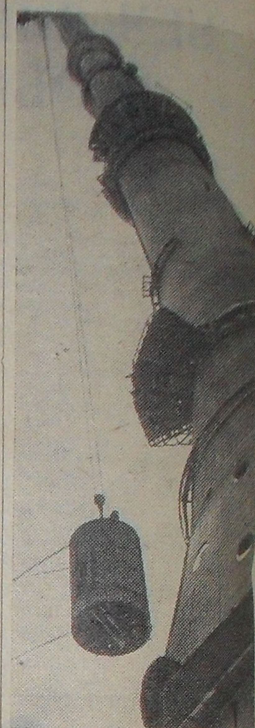
МОСКВА. Монтажник Останкинской телевизионной башни произвели подъем первой 23-тонной секции, являющейся основой металлической автены, которой увенчается высочайшая башня мира. Поднята также вторая секция. После подъема остальных частей антенны высота телебашни достигнет 533 метров. На снимке: подъем секции. Фото Н. Грановского. Фотохроника ТАСС.
