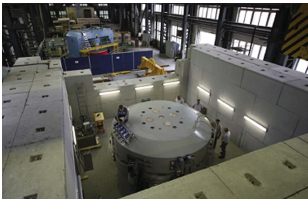
Рис. 3. Размещение протонного циклотрона IBA C235-V3 в здании 5 ЛЯП
