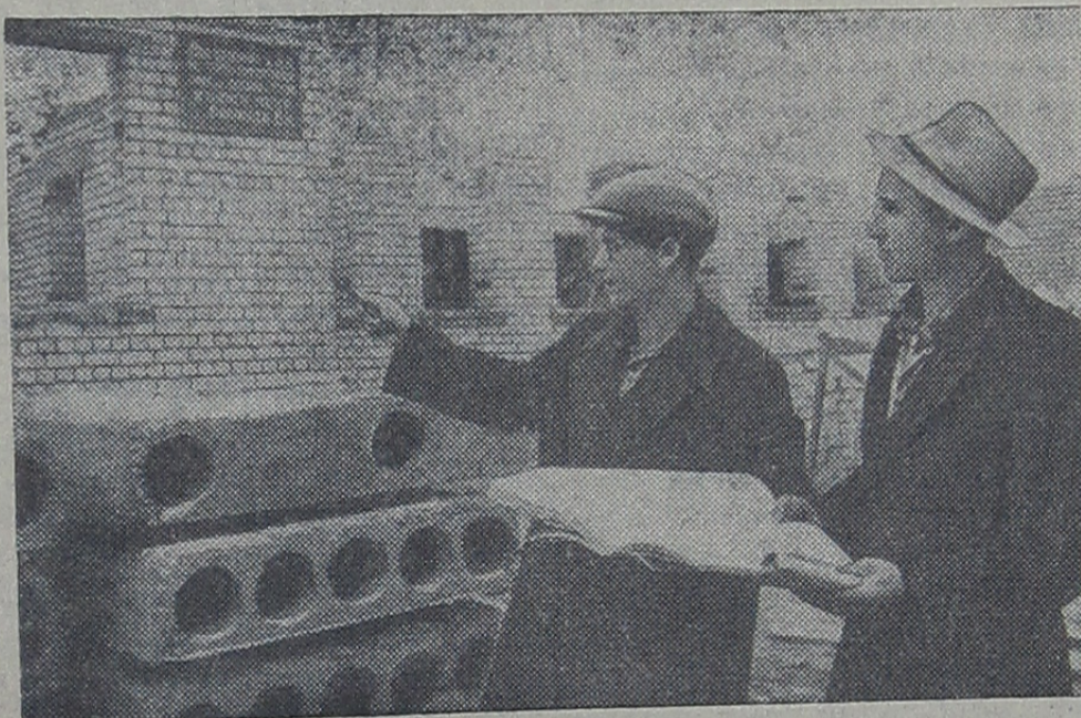
На стройках нашего города трудится много молодых специалистов. На снимке: прораб Ф. Я. Корккяйнен и мастер В. И. Балалаев обсуждают дальнейшие работы по монтажу перекрытия детского сада (15-й квартал). Фото В. Мальберг.
