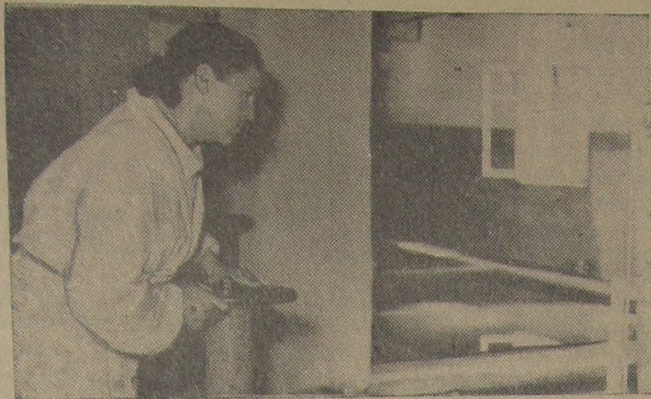
На снимке: фильтровальный зал водозаборных сооружений. Дежурная Комлева Полина Ивановна регулирует уровень воды в бассейнах.
