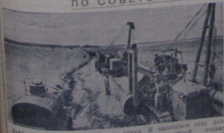
Кубинская область. В этом месте сооружается крупный завод синтетического каучука. В нынешнем году должна войти в строй первая очередь этого завода, который
