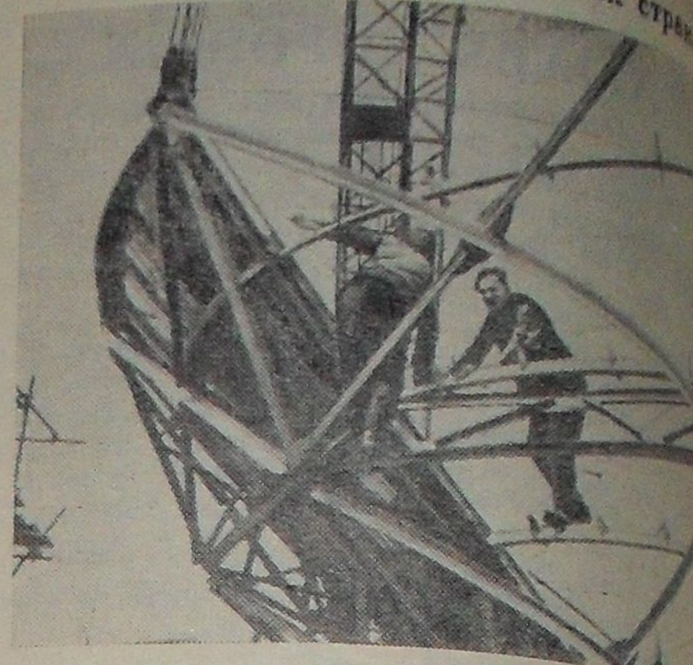
Монтаж мощного радиотелескопа на территории обсерватории Краковского университета (Польша). Антенны радиотелескопа — 12 метров. Фото ЦАФ — ТАСС
